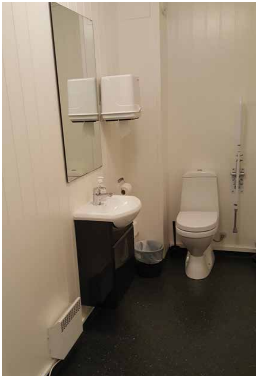
FERDIG: HC-toalettet er klar til innsats igjen.
